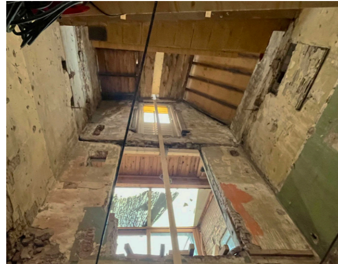
foto's (van boven naar beneden): achtergevel na verwijderen vloeren nieuwe pui 'op de vlucht' lange zichtlijn met vooraan de nieuwe stalen trap
